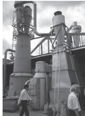
●ペレット製造プラント
